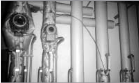
Isolatie van leidingen en verbindingen
