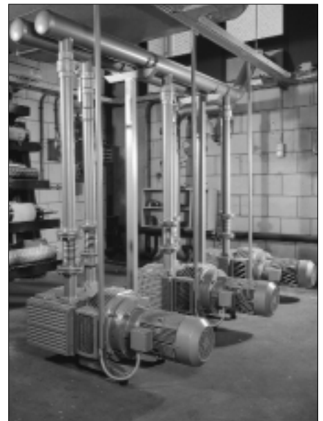
Afbeelding 3: centrale vacuümpompwerking in een drukkerij
