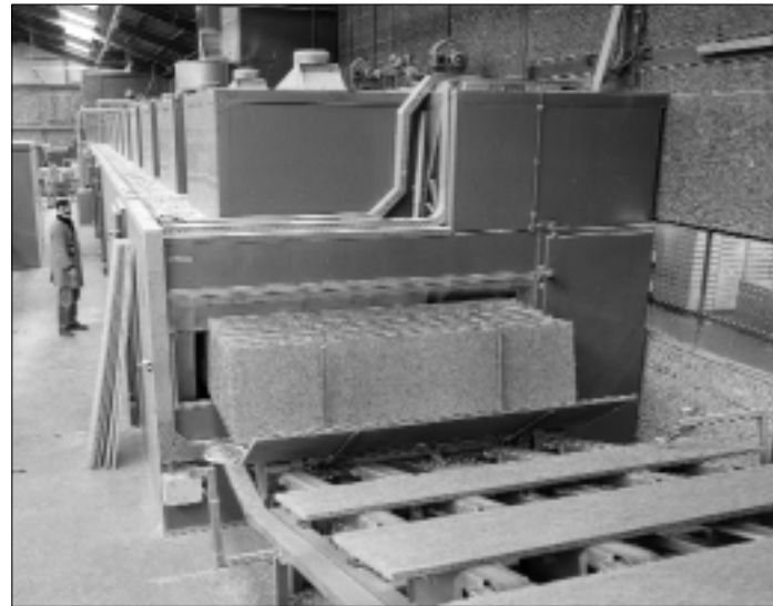
Afbeelding 6: een droogtunnel voor spaanplaat
