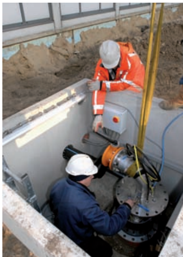
Installatie warmte/koude-opslag (WKO)
