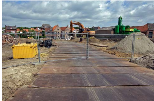
Foto 2: Sanering van het gasfabriekterrein in Bergen op Zoom (foto: Gert van Mil)
