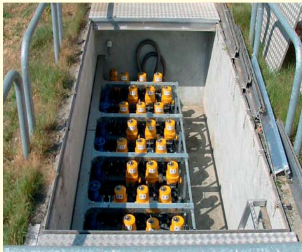
Foto 4: Distributieput grondwatersanering Uden
