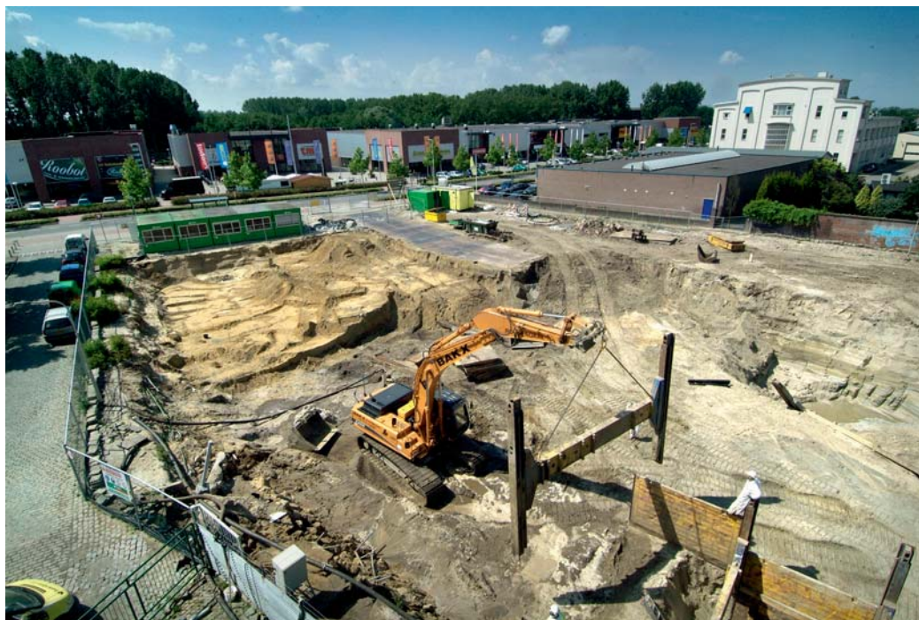
Foto 2.1: Overzicht van de sanering van het gasfabrieksterrein in Bergen op Zoom (foto: Marcel Bekken)
