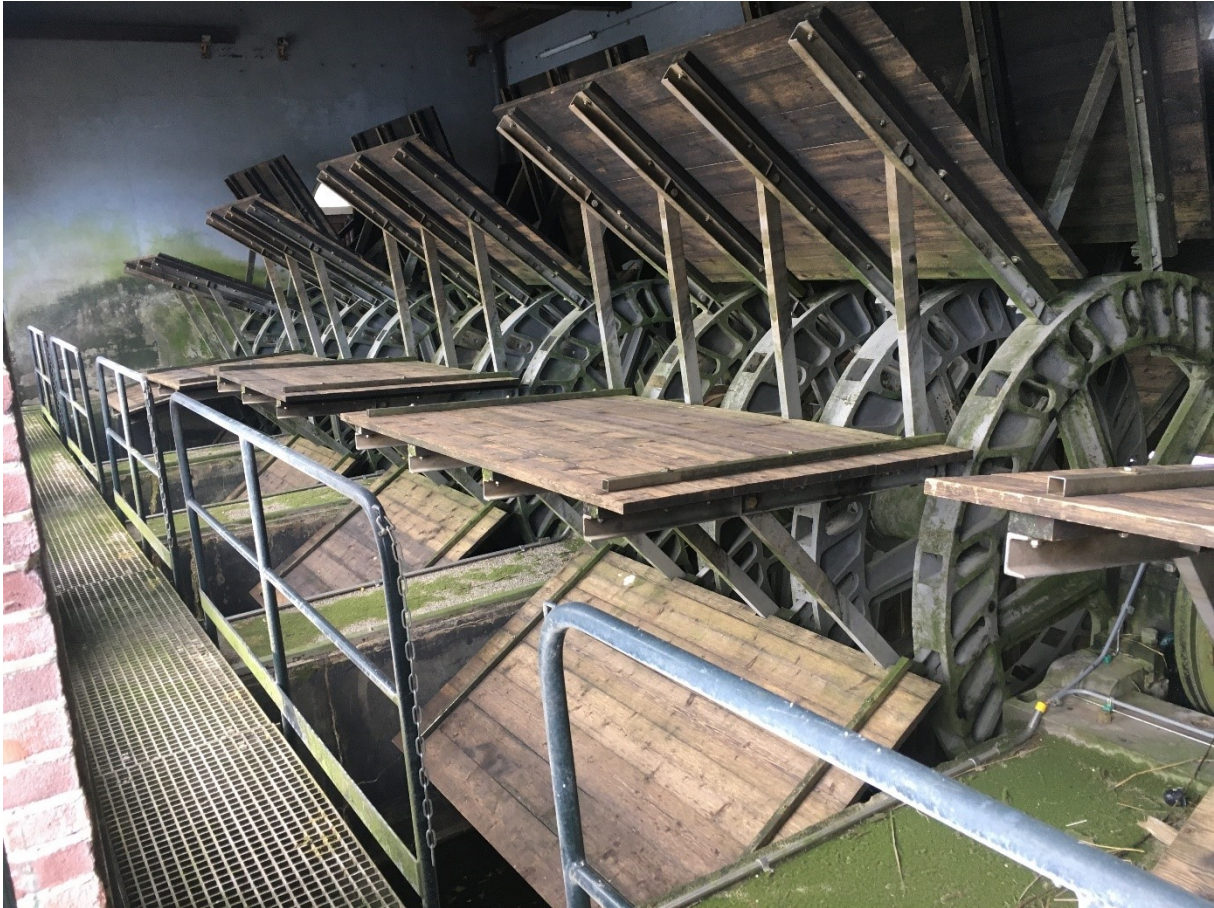
Figuur 4.3. Schepradaren boezemgemaal Spaarndam (Foto: Marco van Wieringen)
