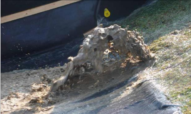
Figuur 6: Uitspoelen van zand door een gat in de binnenbekleding bij golfoverslagproef Tholen (bron: artikel 'Fenomenologische beschrijving afschuiven en/of afdrucken van de bekleding en uitspoelen')
